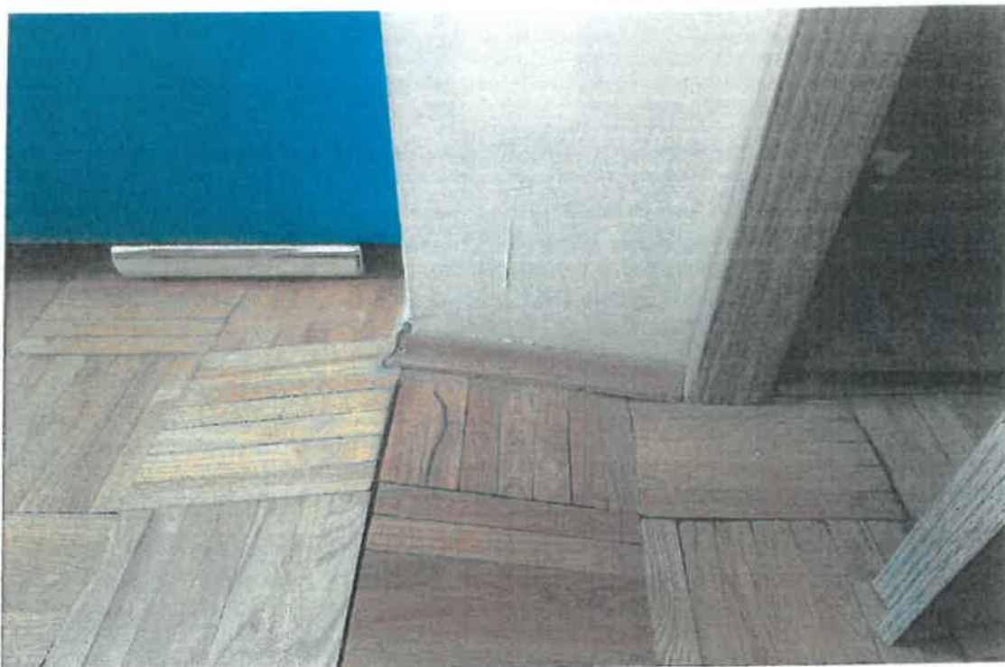
Fotografia nr 54 – Widok uszkodzonej posadzki z mozaiki dębowej po zalaniu w pomieszczeniu nr 401.2 .
