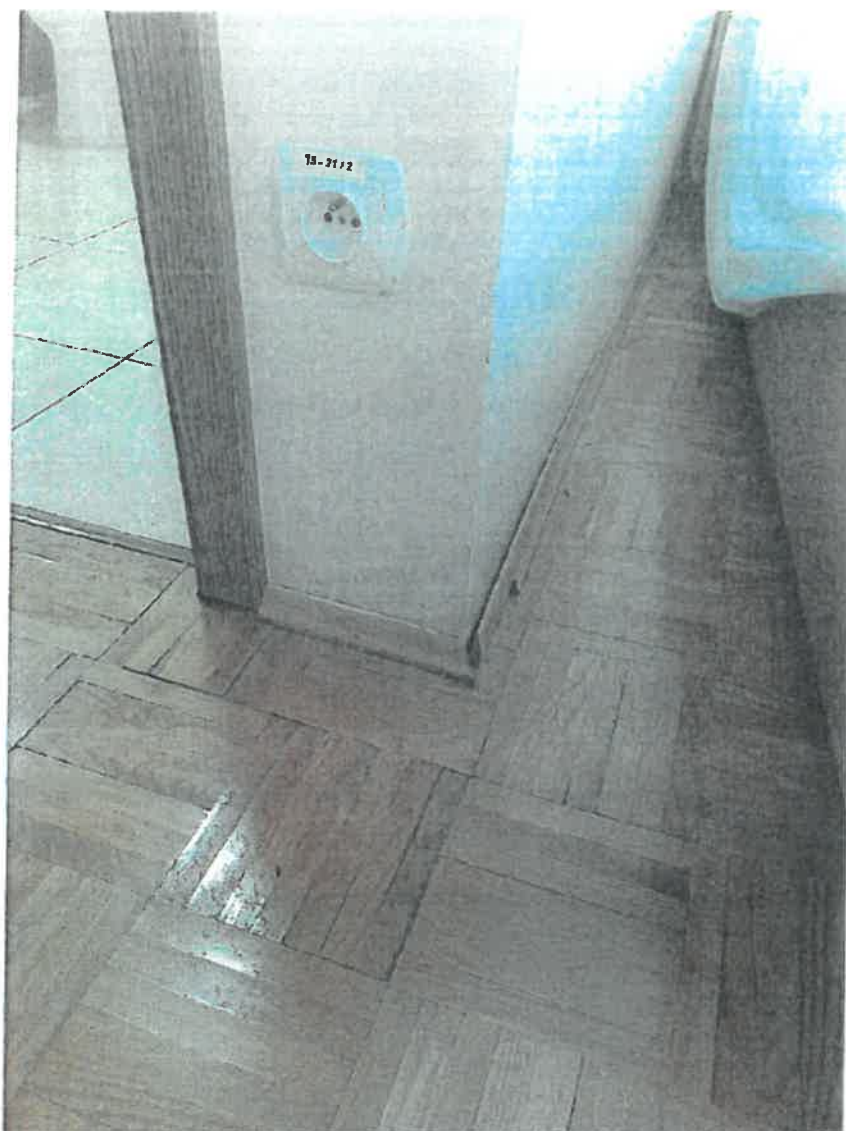
Fotografia nr 4 – Widok uszkodzonej posadzki po zalaniu w pomieszczeniu nr 501.1 .
