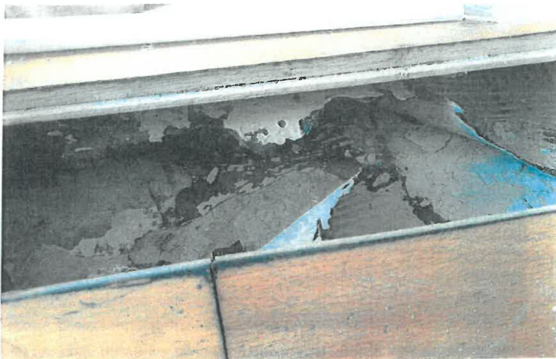
Fotografia nr 58 – Widok uszkodzonej posadzki po zalaniu w pomieszczeniu nr 309.2 . Poniżej parkietu dębowego jako warstwa wyrównująca jest zastosowana płyta pilśniowa miękka. Duże pęcznienie parkietu oraz duże pęcznienie płyty pilśniowej spowodowało odspojenie parkietu od podłoża posadzki.
