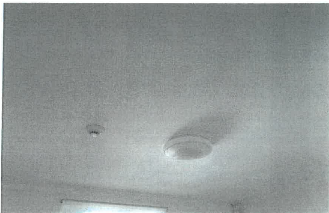
Fotografia nr 53 – Plamy na suficie w pomieszczeniu nr 401.2. Plamy te spowodowane są zalaniem.
