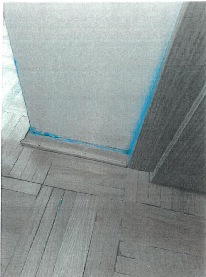
Fotografia nr 7 – Widok uszkodzonej posadzki po zalaniu w pomieszczeniu nr 501.1 .
