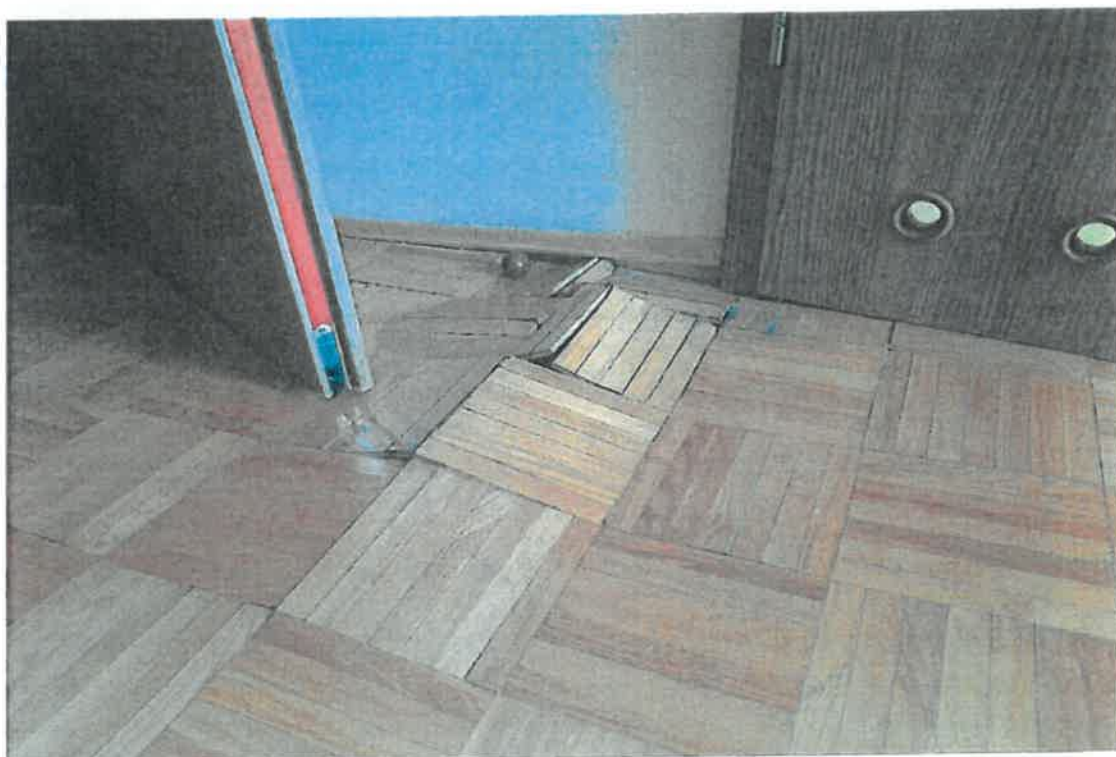
Fotografia nr 18 – Widok uszkodzonej posadzki po zalaniu w pomieszczeniu nr 506.2 .
