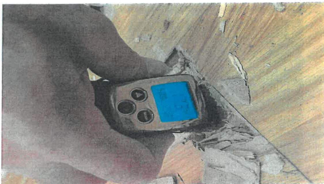
Fotografia nr 73 – Pomiar wilgotności drewnianych trójwarstwowych paneli podłogowych w pomieszczeniu nr 102. Wilgotność paneli W_{\text{panelu}} = 17,3\% . Dokonano pomiaru wilgotności wewnętrznej warstwy panelu.
