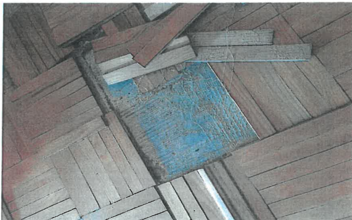
Fotografia nr 57 – Widok uszkodzonej posadzki po zalaniu w pomieszczeniu nr 401.2 . Poniżej mozaiki dębowej jako warstwa wyrównująca jest zastosowana płyta pilśniowa miękka. Duże pęcznienie mozaiki parkietowej oraz duże pęcznienie płyty pilśniowej spowodowało odspojenie mozaiki parkietowej od podłoża posadzki.
