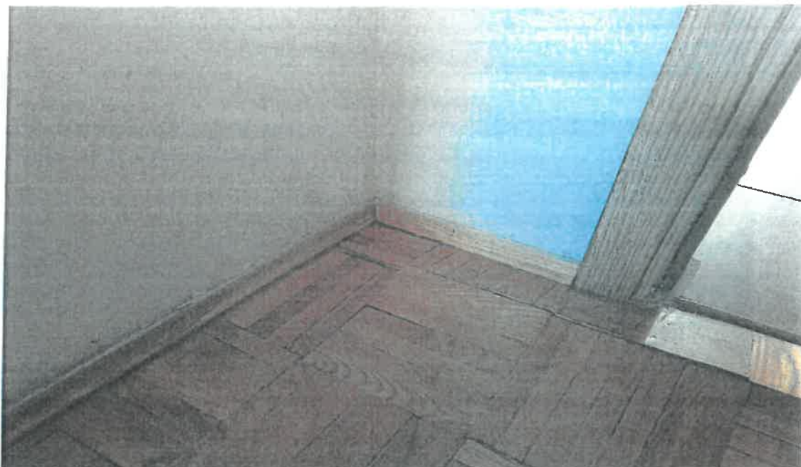
Fotografia nr 56 – Widok uszkodzonej posadzki z mozaiki dębowej po zalaniu w pomieszczeniu nr 401.2 .
