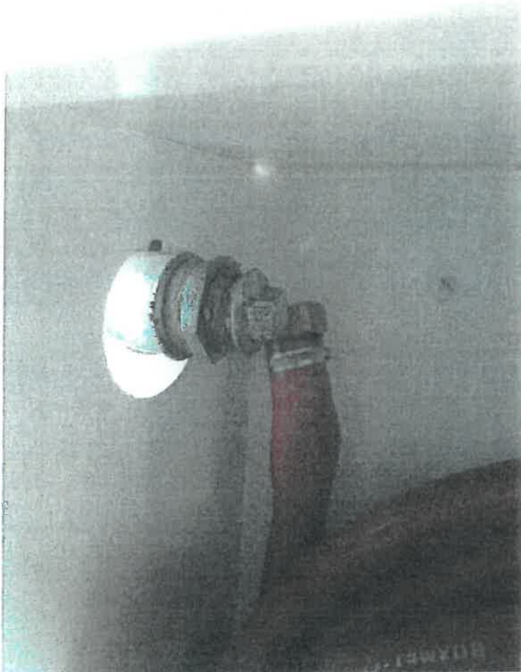
Fotografia nr 2 - Widok zaślepionej instalacji przeciwpożarowej, w miejscu gdzie wystąpiła awaria.
