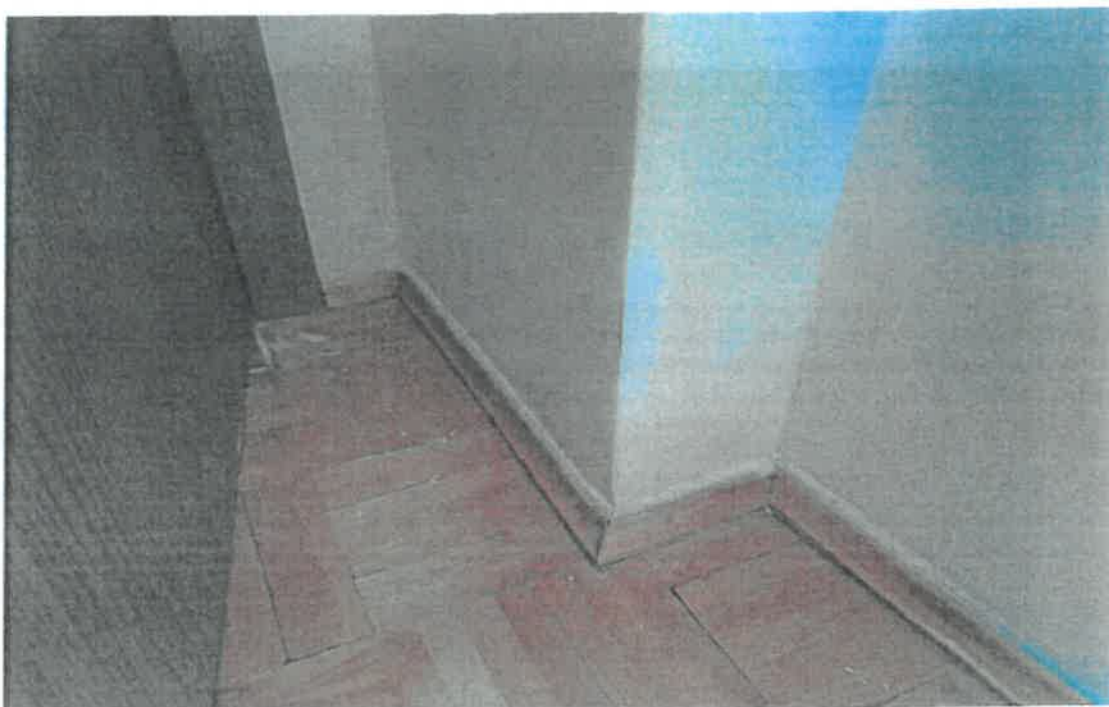
Fotografia nr 14 – Widok uszkodzonej posadzki po zalaniu w pomieszczeniu nr 506.2
