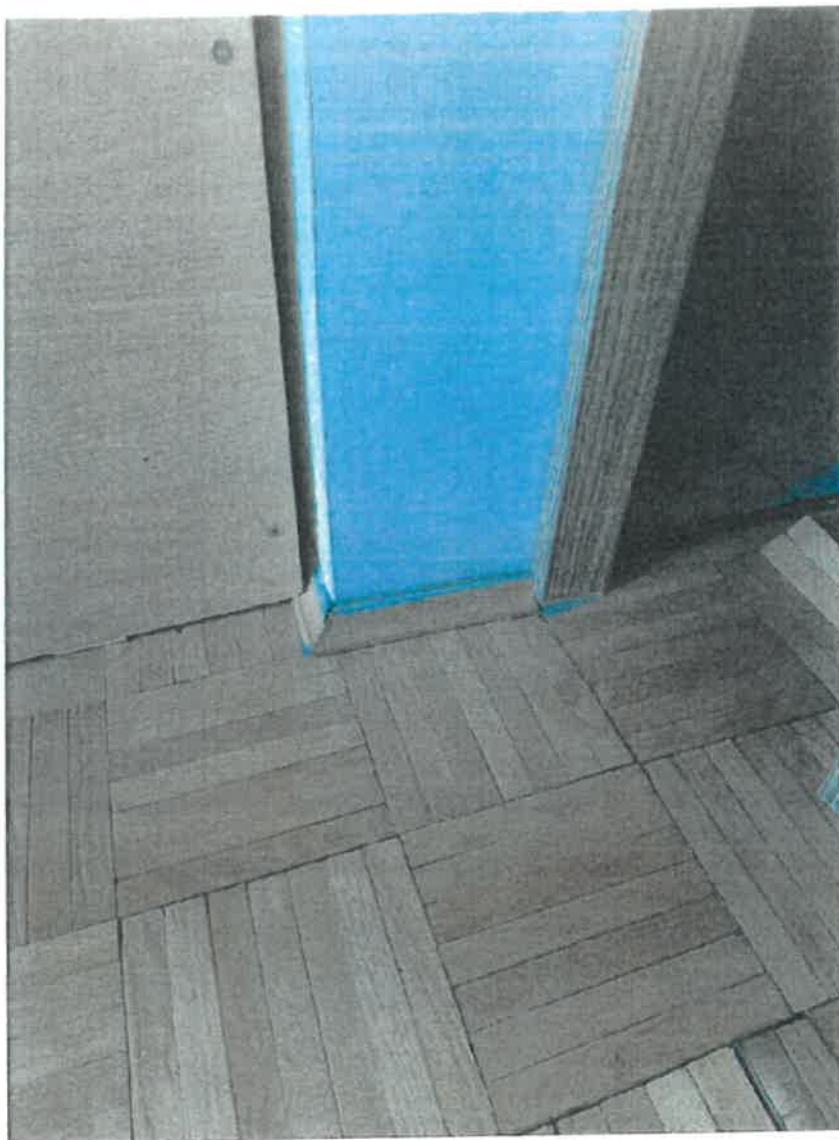
Fotografia nr 39 – Widok uszkodzonej posadzki po zalaniu w pomieszczeniu nr 409.2 .
