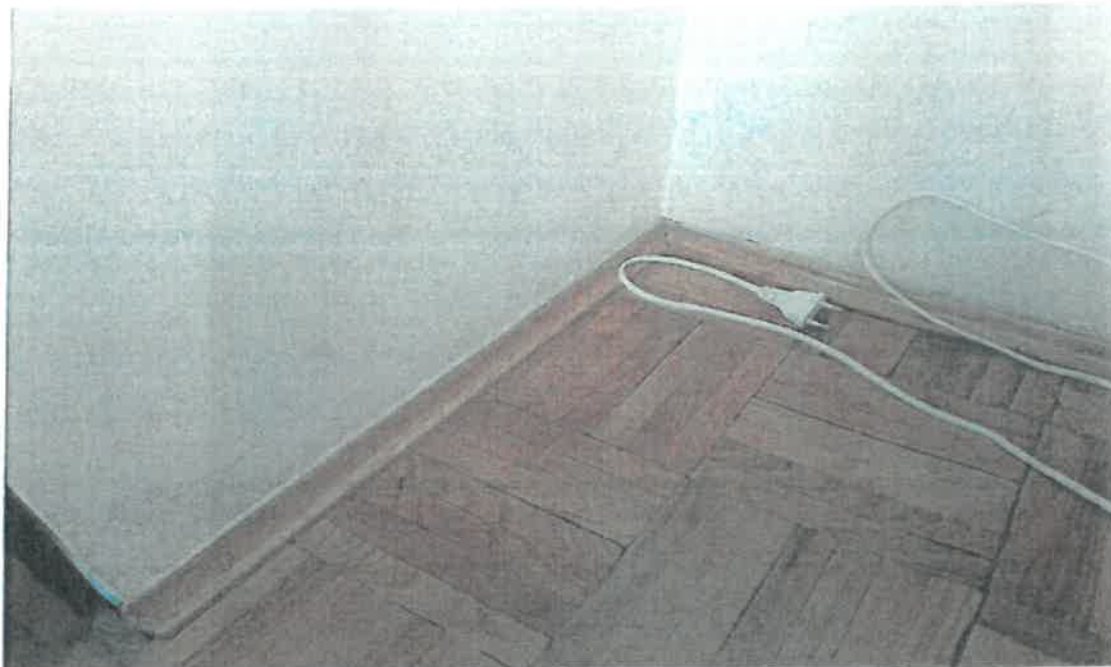
Fotografia nr 5 – Widok uszkodzonej posadzki po zalaniu w pomieszczeniu nr 501.1 .
