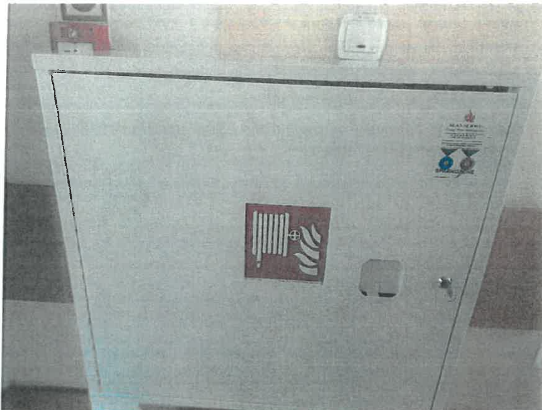
Fotografia nr 1 – Widok skrzynki przeciwpożarowej na piątym piętrze.
