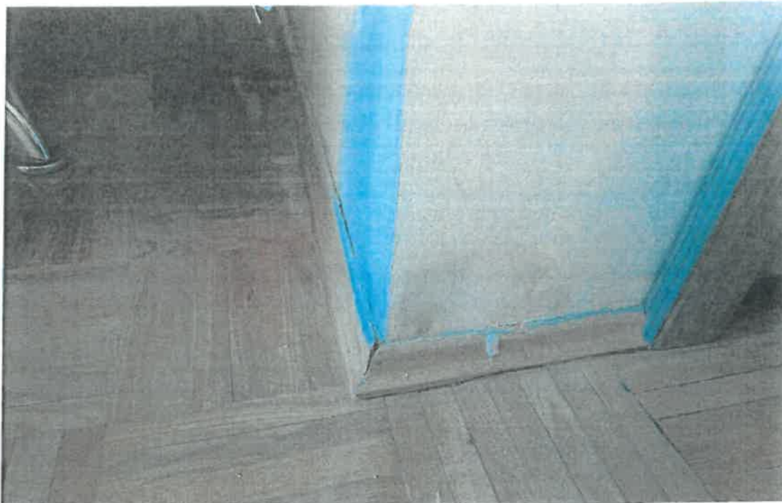
Fotografia nr 13 – Widok uszkodzonej posadzki po zalaniu w pomieszczeniu nr 506.2 .
