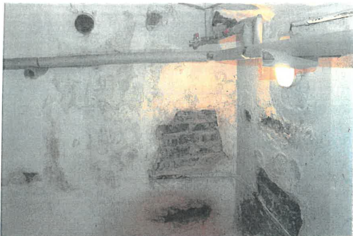
Fotografia nr 76 – Widok starych ustabilizowanych zawilgoceń murów ścian fundamentowych piwnic. Korozja tynku nie pochodzi z zalania budynku.
