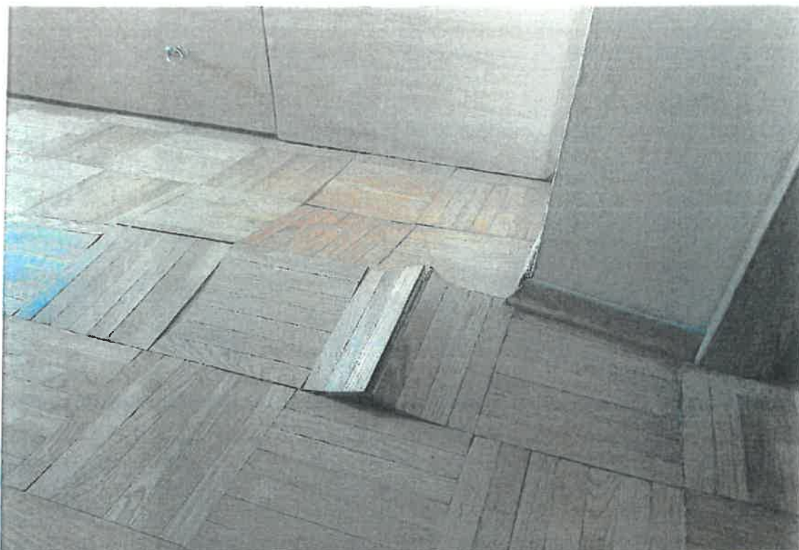
Fotografia nr 46 – Widok uszkodzonej posadzki z mozaiki dębowej po zalaniu w pomieszczeniu nr 403.2 .
