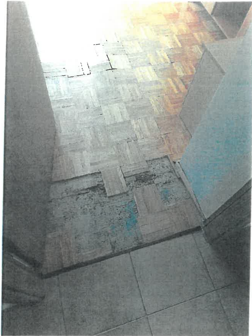
Fotografia nr 3 – Widok uszkodzonej posadzki po zalaniu w pomieszczeniu nr 508.2 .
