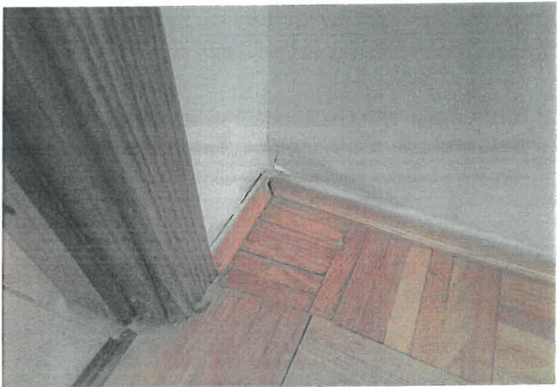
Fotografia nr 51 – Zawilgocona ściana i posadzka w pomieszczeniu nr 402.2.
