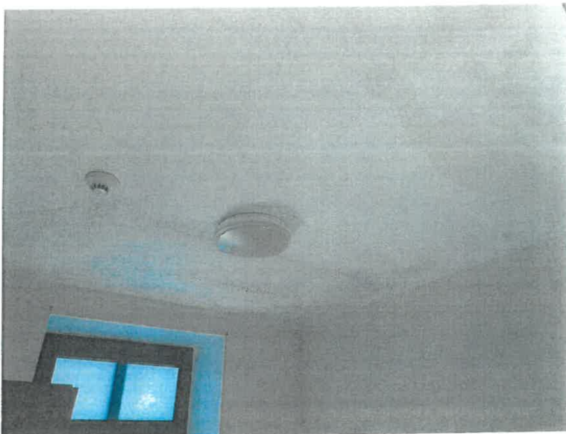
Fotografia nr 45 – Plamy na suficie w pomieszczeni nr 403.2. Plamy te spowodowane są zalaniem.
