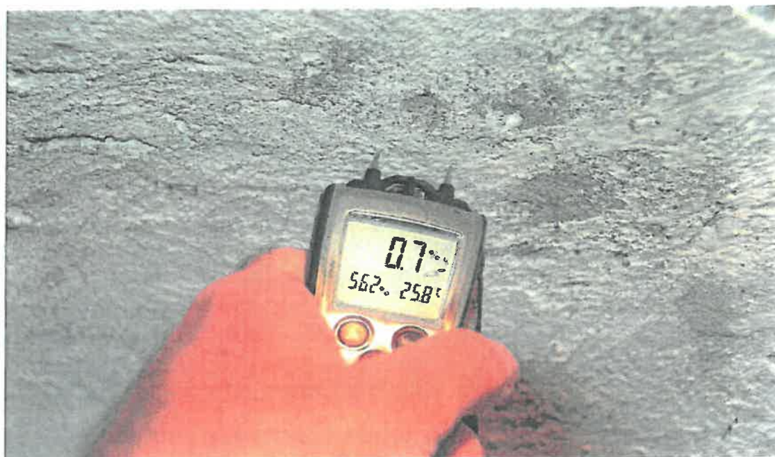
Fotografia nr 75 – Pomiar wilgotności na powierzchni stropu piwnicy. Wilgotność stropu jest w normie. Strop w tej części piwnicy nie uległ dodatkowemu nawilżeniu przez wodę pochodzącą z zalania.
